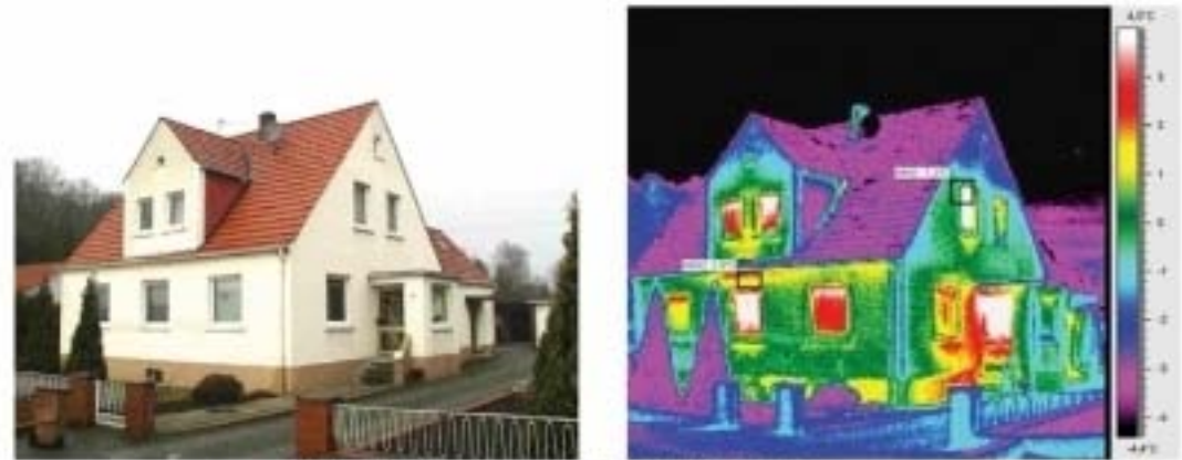
Zustand eines Hauses v o r der Sanierung
